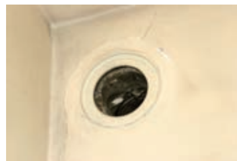
شکل ۱-۴ دودکش در محل نصب آب گرم کن.
