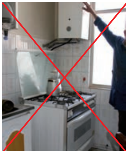
شکل ۱-۶ نصب نادرست آب گرم کن.
