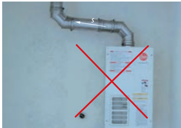
شکل ۱-۳۶ اتصال نادرست دودکش
